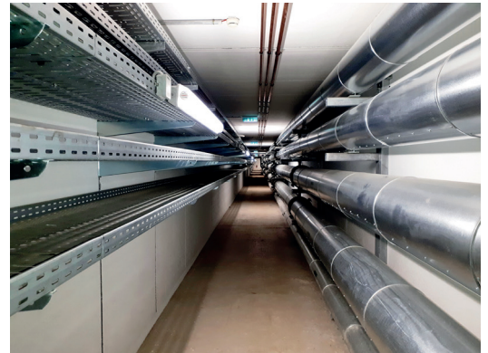
Bild: Unterirdischer begehbare Leitungskanal.
